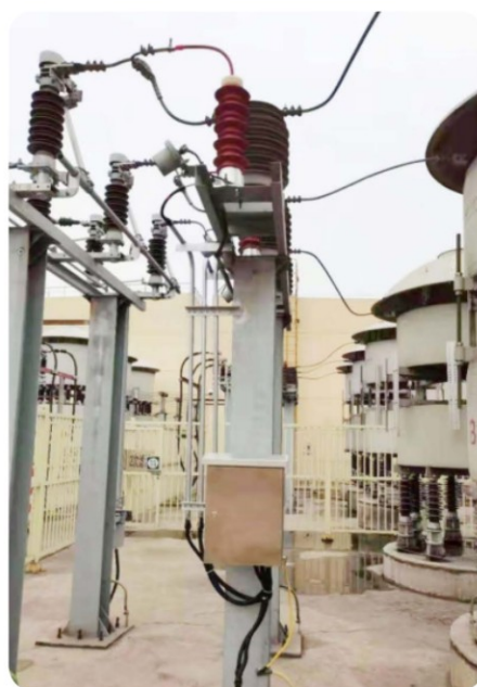
智能避雷器及端子箱客户现场运行照片
