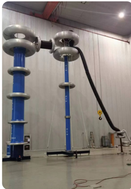
1000kV工频耐压试验装置
